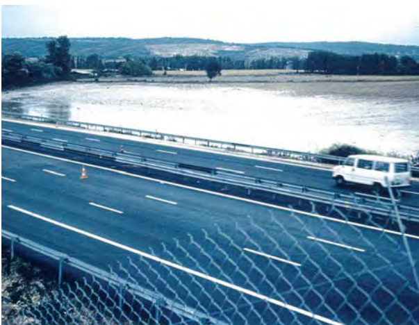
Crue du 23 septembre 1993, secteur de l'A8 au franchissement du vallat des Marseillais sur la commune d'Eguilles
