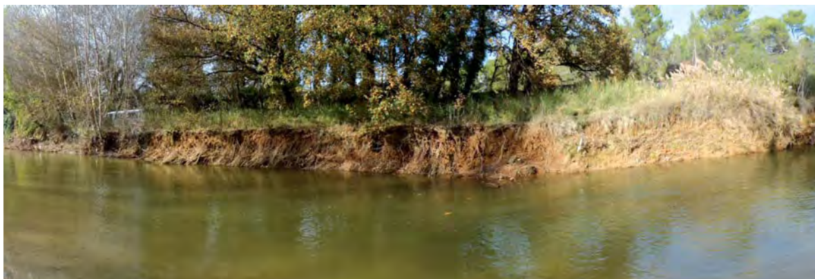
Érosion sur l'Arc à Aix-en-Provence, 2012
