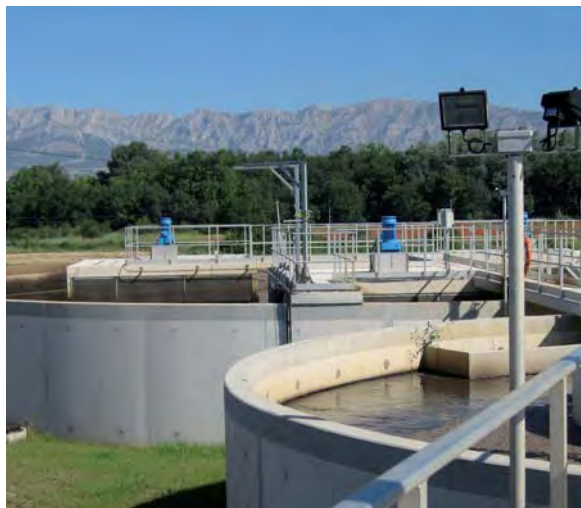
Station d'épuration de Trets
